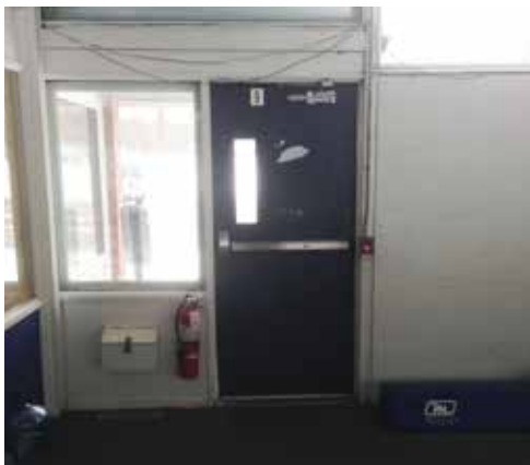
Non ADA-compliant doors.
